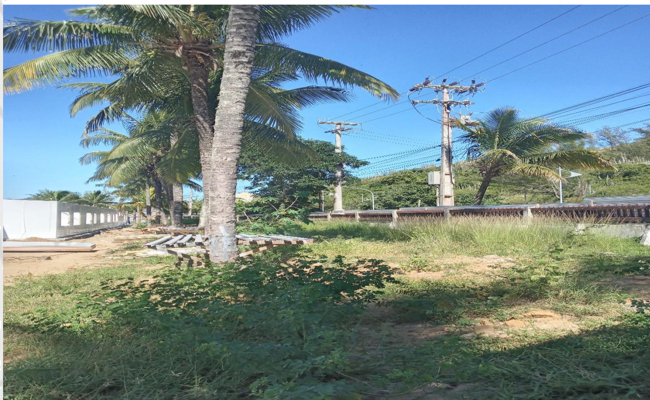
F 04- Mato em toda área do entorno da obra, e peças metálicas sendo pintadas fora do local apropriado.
