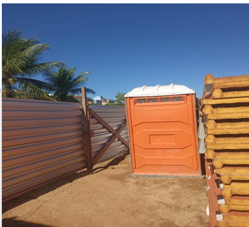
F 08- Banheiro químico fora do padrão de higiene como local para banho , sanitário , troca de roupa,
