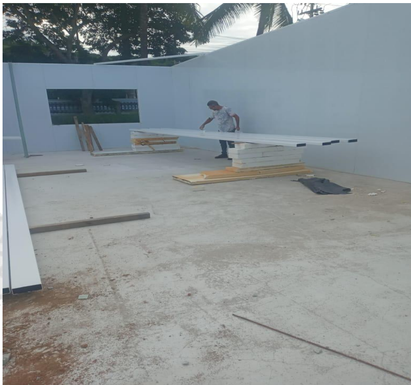
F 07- Funcionário sem uso de EPI's para serviços de pintura e manuseio com produtos tóxicos.
