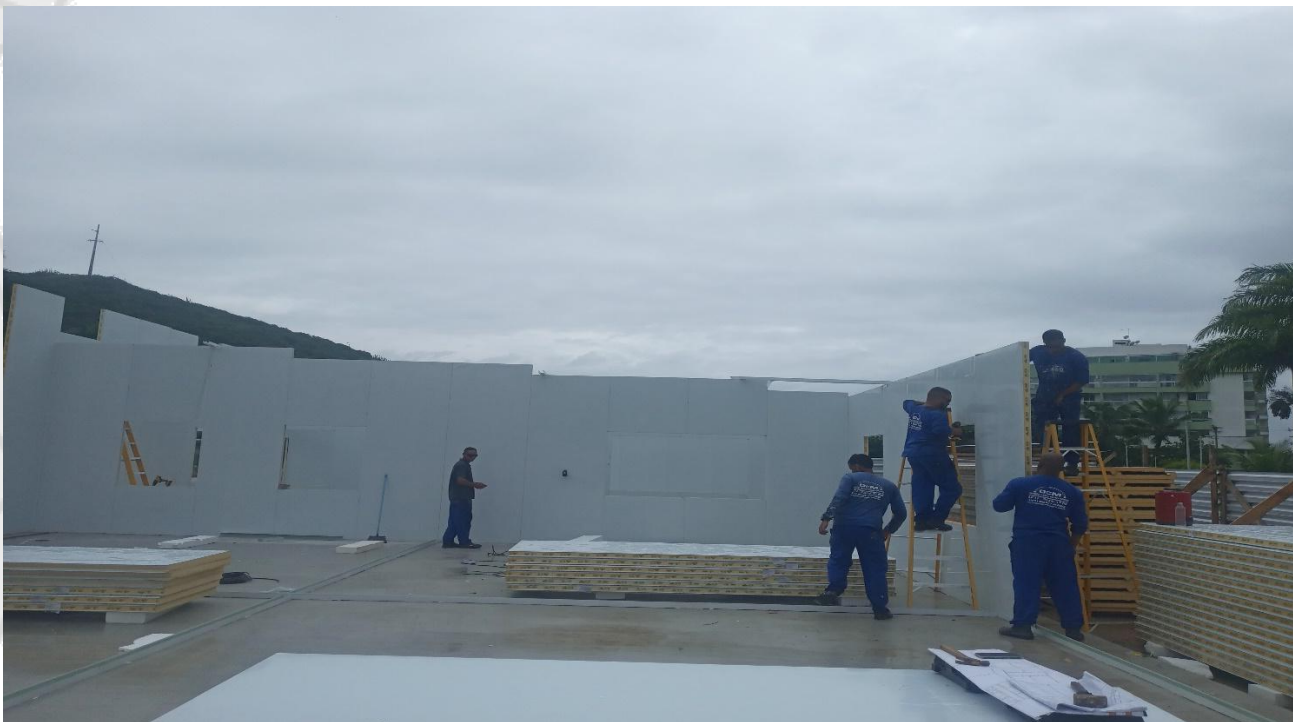
F 01- Funcionários sem o uso de EPI's, e equipamentos para trabalhando em altura . NR35
