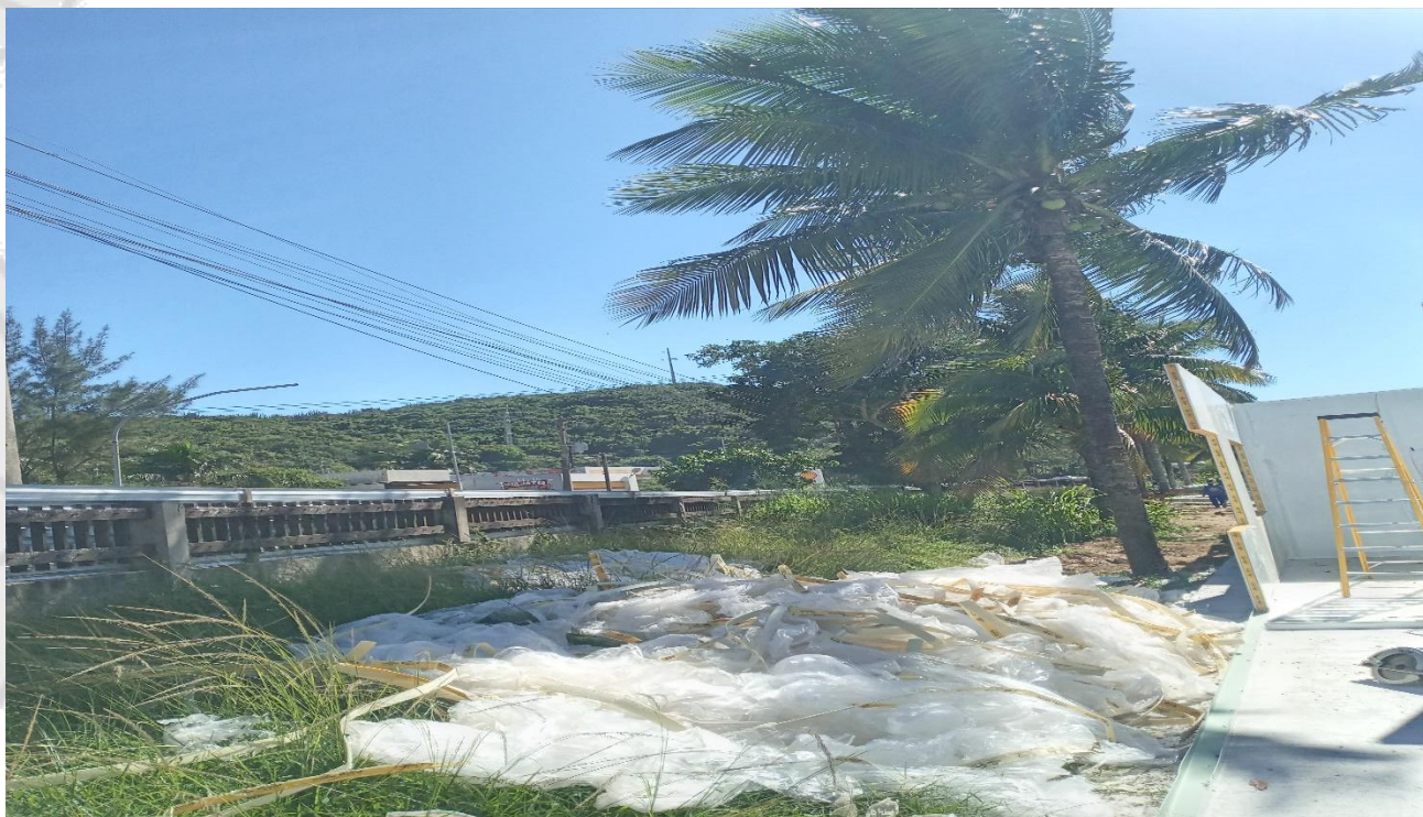
F 03- Canteiro de obra com vegetação (mato) e lixo gerado pela obra
